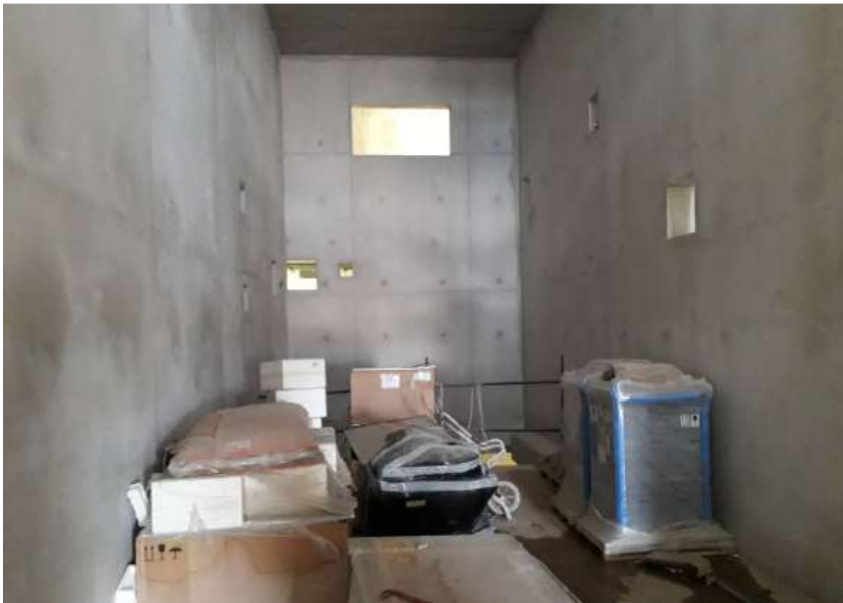
Local et fosse de dépotage des boues
