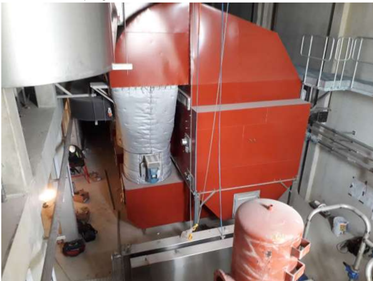
Sécheur à boues
