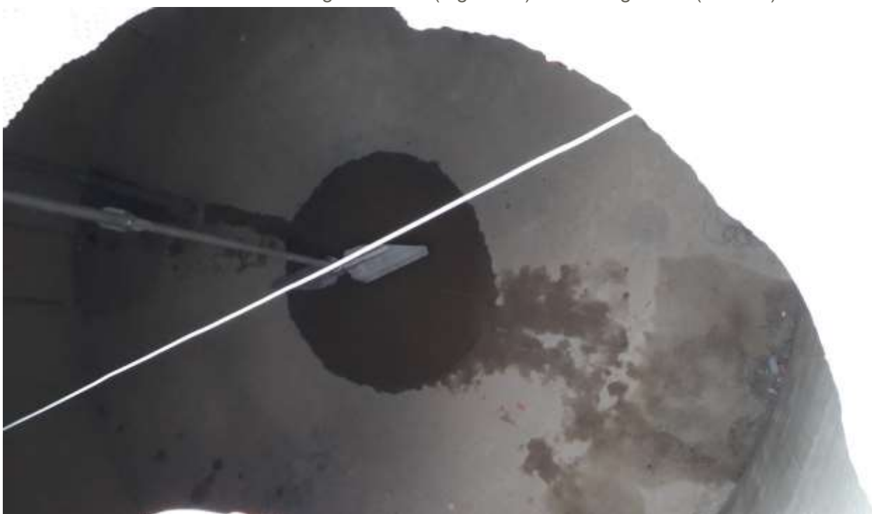
Vue intérieure d'un digesteur
